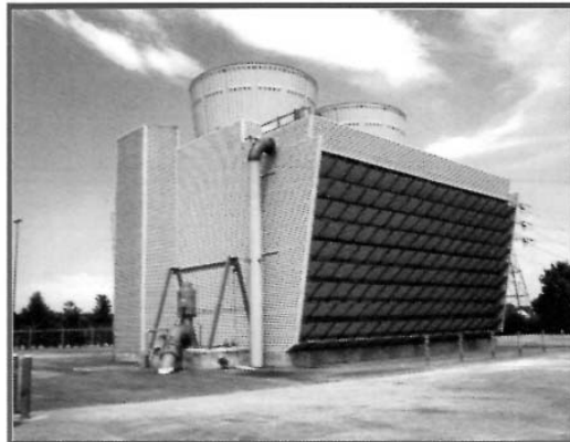
TORRES DE ENFRIAMIENTO
